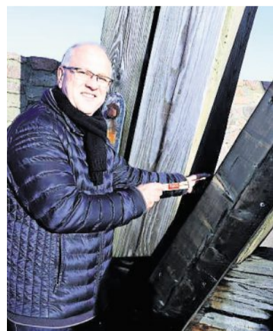
Der Diagonalbalken (vorne) muss raus: Mit einem Zollstock markiert Lutz Rothermundt die Stelle, an welcher der Fäulnisprozess begann.
